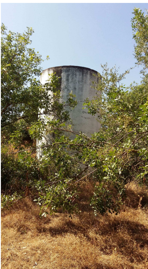
Izda: Depósito acumulador de agua Ø2,5m, h:3,5m
